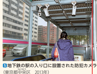
5 地下鉄の駅の入り口に設置された防犯カメラ (東京都中央区 2013年)
